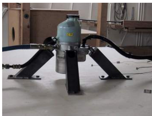
Abbildung 6: Pumpe auf der Platte montiert
