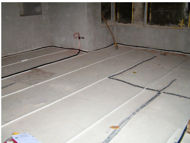
Bild 2: ausgelegte Kabel eines phased Arrays im Boden des Hauses der Begegnung in Leipzig
