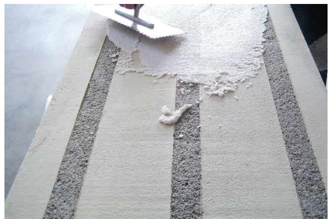
Abbildung 2: Verputzen des Schlitzabsorbers 40/15-50/200 (= 40 mm Dämmmaterial / 15 mm Putz – 50 mm Schlitzbreite / 200 mm Rasterweite – Schlitz mit Zellulose gefüllt) mit 3mm dickem porösem Grobkornputz.
