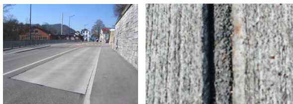
Abbildung 4: Betonelemente an einer Bushaltestelle (links) und eine vergrößerte Fuge zwischen zwei Betonelementen (rechts).
