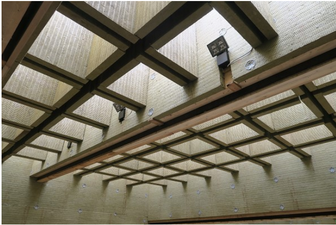
Abbildung 4: Rasterdecke aus Mineralwolle einschließlich Wandbekleidungen für Mehrdistanzschießen.
