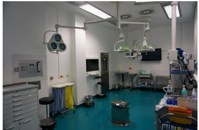
Abbildung 1: Ansicht des Operationssaales
