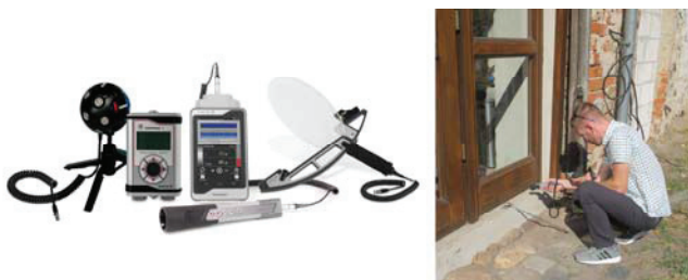
Abbildung 3: Suche nach energetisch wirksamen Fehlern entlang der Türdichtungen der historischen Kulturscheune mit mobiler Ultraschallprüftechnik. Da das Ultraschall-Sende-Empfangsverfahren manuell scannend erfolgt, wird entsprechend der konstruktiv bedingten Erwartung abgetastet.
