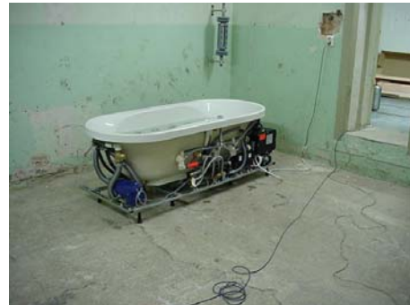
Bild 1: Whirlpool in einem Deckenprüfstand eingebaut.
