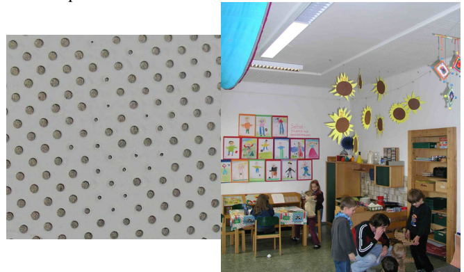
Figur 5 (links) / Figur 6 (rechts): Links eine überstrichene bzw. "zugeweißelte" Dämmplatte samt unterschiedlichen Lochöffnungen in vergrößerter Nahansicht; rechts ein typischer Kindertagesstätten-Aufenthaltsraum in [4] mit besagten, "beschädigten" Dämmplatten oben, hinten rechts an der Decke befestigt sowie PVC-Boden.
