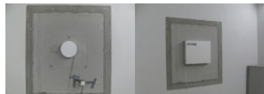
Abbildung 3: Einrohr-Lüftungssystem und dezentrale Lüftungsanlage bei der Messung der Norm-Schallpegeldifferenz D_{n,e} im Fensterprüfstand an der HFT Stuttgart.
