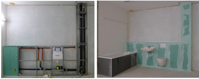
Abbildung 1: Aufbau des Vorwand-Installationssystems (links) im Prüfstand und komplette Musterinstallation mit den zu untersuchenden Sanitärinstallationen (rechts)
