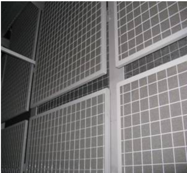
Abb.4 Fernsehstudio: Wandverkleidung mit nichtbrennbarem Gewebe hinter Baustahlgewebe. Dahinter Schallschluckmaterial.
