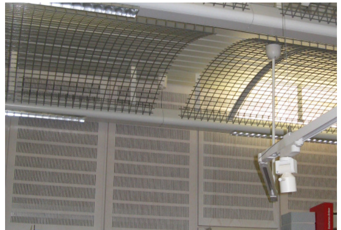
Abb. 5: Regieraum Hörfunk: Wände mit Schlitzplatten, dahinter Mineralfaser, Decke mit Gitter, Stoffbespannung
