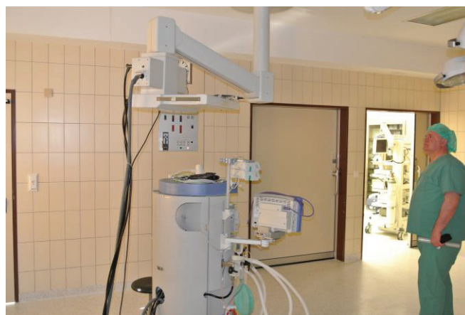
Abbildung 1: Messstation im OP 2, Klinikum am Park Lünen. Die Messgeräte mussten so platziert werden, dass sie das OP-Team während der Arbeit auf keinen Fall stören und es auch keine Probleme mit der Krankenhaushygiene gibt.
