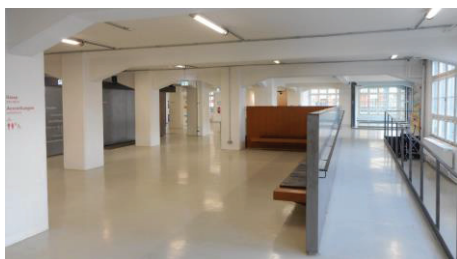
Abbildung 9: Unterhangdecke als Schallabsorber einschließlich neu montierter Beleuchtung
