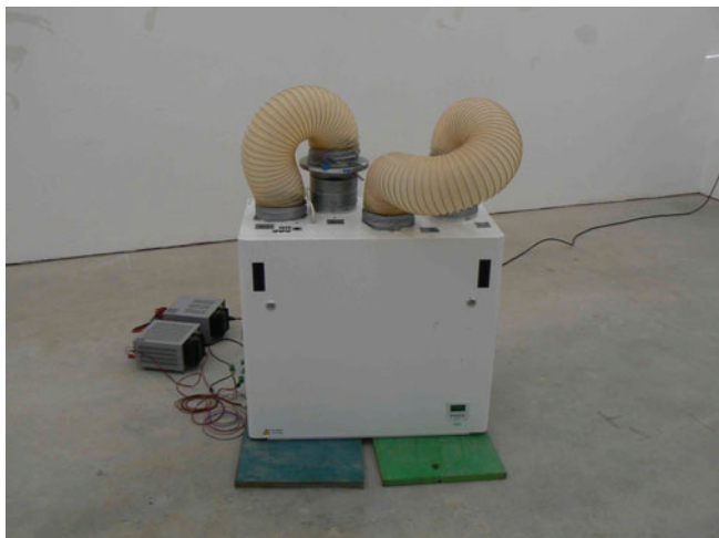
Abbildung 7: Wohnungslüftungsgerät mit flexiblen Kunststoffleitungen und Irisblenden in jedem Luftweg. Aufbau im Hallraum der HFT Stuttgart.
