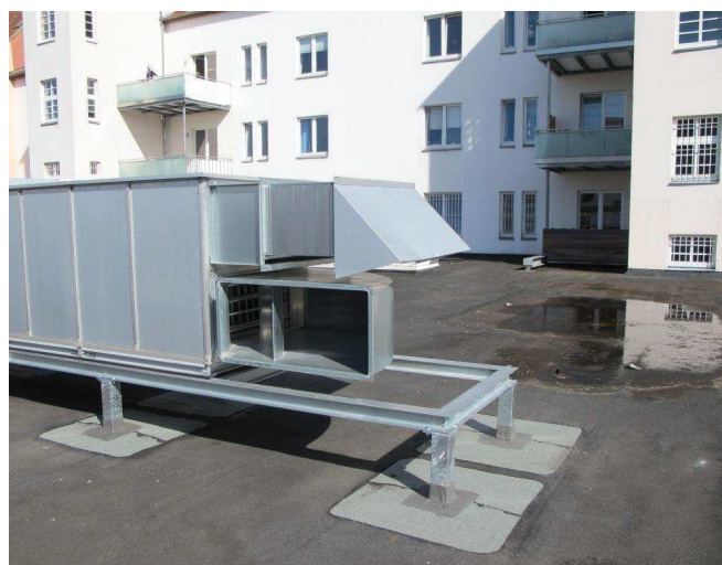
Abbildung 9: Lüftungsanlage wirkt auf Rückfassade ein.
