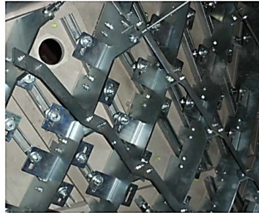
Abb. 6: Rückseitige Befestigung eines Gips-Panels an einer Unterkonstruktion wie in Abb. 5 (Foto: Peuckert GmbH)
