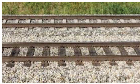
Abbildung 6: Eingebaute Schwellentypen der Gleisstrecken im Großraum Wien (Aufnahme Messpunkt Kottingbrunn)
