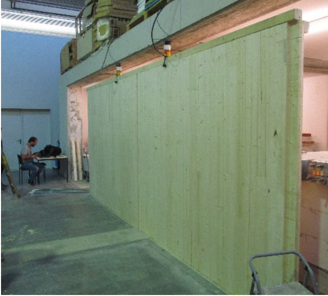
Abbildung 2: Einbau der Brettsperrholzwand im Flankenprüfstand der HFT Stuttgart. mit Hydraulikzylinder zur Simulation einer Auflast.
