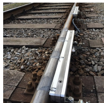
Abbildung 2: an der Schienenaußenseite montierte Leisten zur Aufbringung des Konditioniermittels am Schienenkopf.
