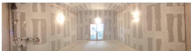
Abbildung 2: SR-Variante SR00: leerer Senderaum, im Messbetrieb bis auf Messeinrichtungen sowie Lautsprecher vollkommen leer
